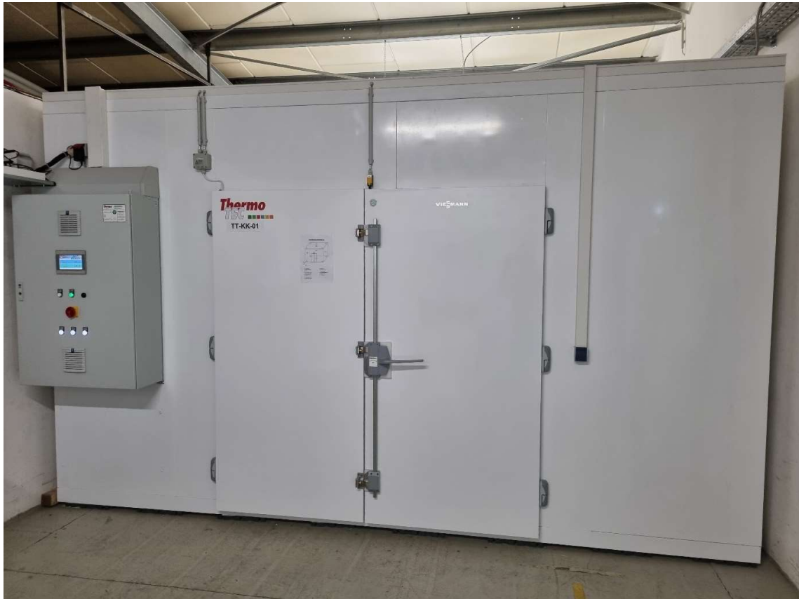
Frontansicht der neuen Klimakammer. Die räumlich zur Verfügung stehende Fläche wurde optimal und „maßgeschneidert“ ausgenutzt.
